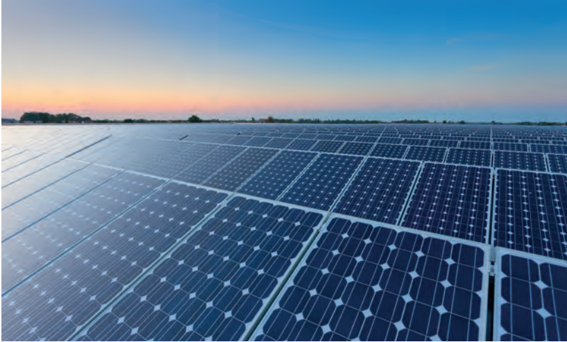
Abb. 6.1.1: Photovoltaik-Freiflächenanlage | Quelle: Fotolia
