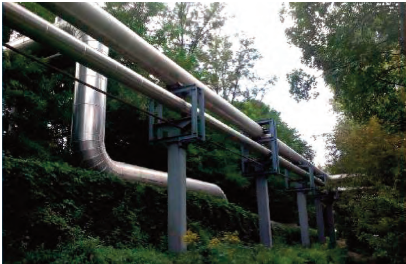
Abb. 3.2.3.1: Fernwärmeleitung Quelle: Dr. Born – Dr. Ermel GmbH
